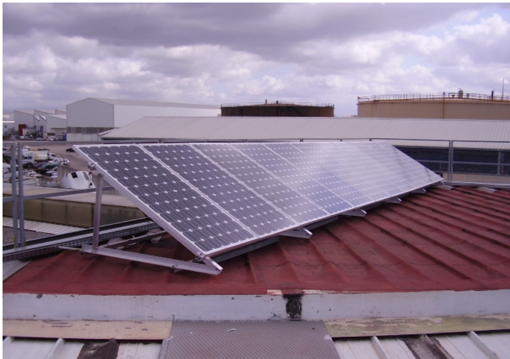
Sezione di impianto ATR PV da 30kW grid distribuito integrato su antico capannone industriale - (NA)
