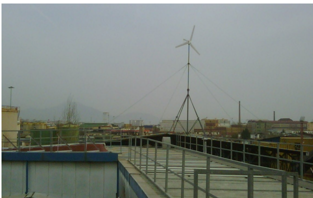
Generatore eolico (5kW) integrato sul capannone
